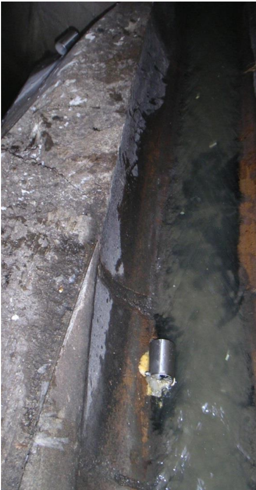
Abbildung 190: Eingebaute Temperatursensoren in einem Weizer MWÜ
